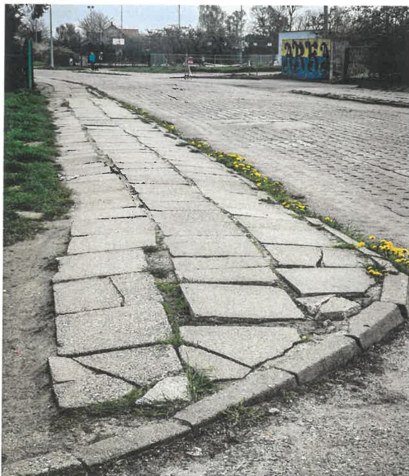
Załącznik nr 1 – Uszkodzony chodnik przy ul. Nowy Świat
